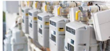
スマートメーター
